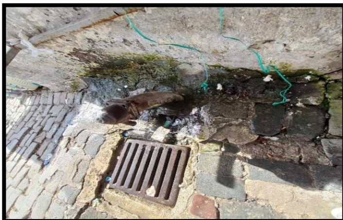
الصورة 17: تسرب المياه لأسفل الجدران الخارجية (عن الباحثين).
